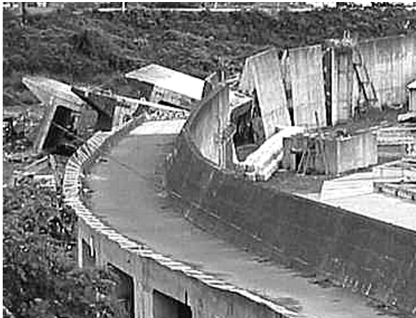
写真3 釜石市唐丹小白浜漁港の破壊された防波堤 (出典：青山貞一撮影)
